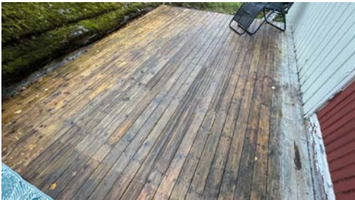
Terrassedekke er noe værslitt.
