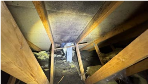
Fuktmerker/svertesopp i taktro.
