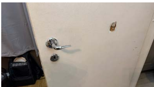
Døren har skade og knekt dørvrider.
