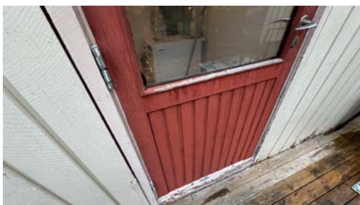
Terrassedør er utvendig værslitt.
