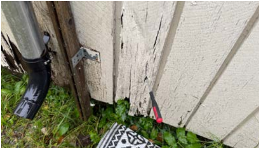
Det er påvist spredte råteskader i bordkledningen.
