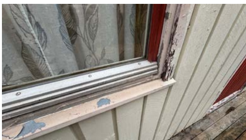
Enkelte vinduer er noe utvendig værslitt.
