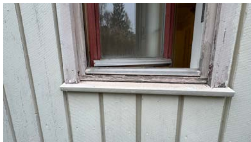
Enkelte vinduer er noe utvendig værslitt.
