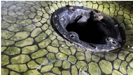
Sluken mangler en skrue på klemringen.
