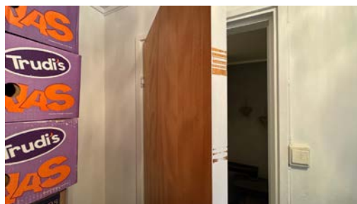
Døren har slitasje.
