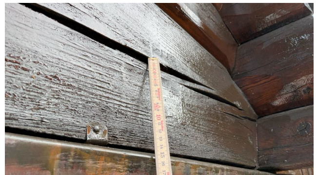
Sprekkekannelse på over 10mm.
