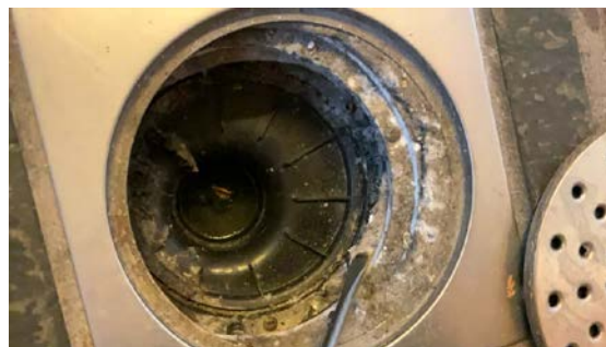
Plastsluk i gulv.
