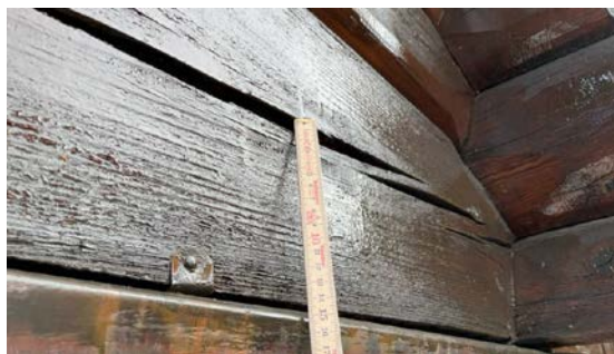
Sprekkdannelse på over 10mm.
