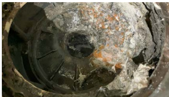
Plastsluk i gulv.
