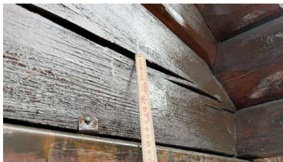
Sprekkekannelse på over 10mm.
