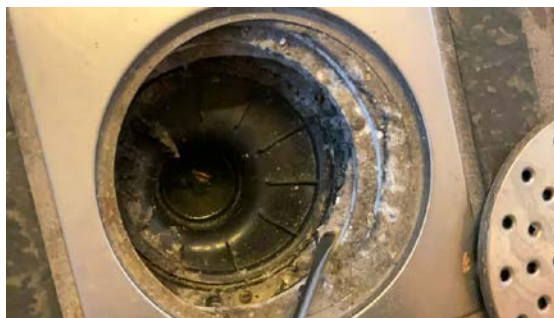
Plastsluk i gulv.
