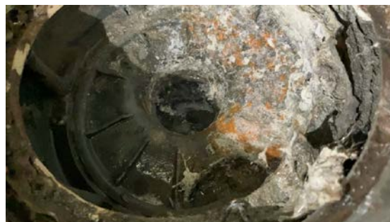
Plastsluk i gulv.
