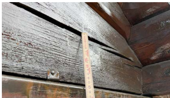
Sprekkdannelse på over 10mm.
