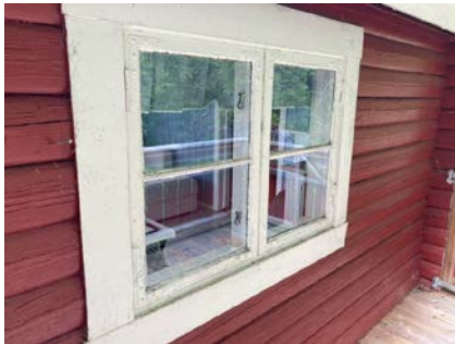
Vinduer trenger jevnlig vedlikehold.
