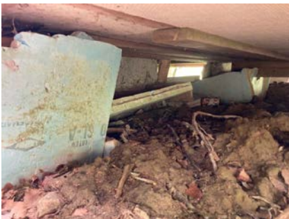
Uoversiktlig og delvis provisorisk fundamentering under hytta.
