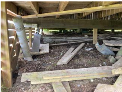
Fundamentering av terrasse må utbedres.
