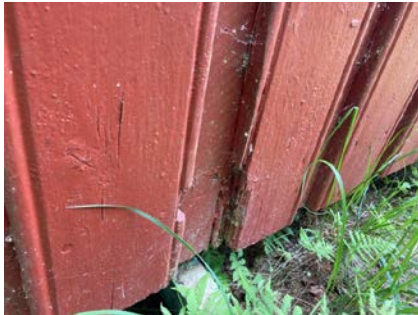
Skader i nedkant av trekledning.
