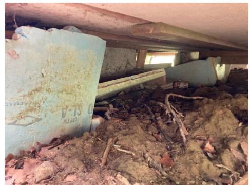
Uoversiktlig og delvis provisorisk fundamentering under hytta.
