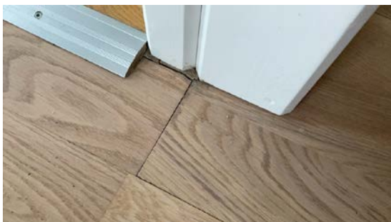
Gliper i parkett ved trapp i 2. etasje.
