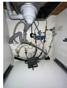
Røropplegg i kjøkkenbenk med Waterguard
