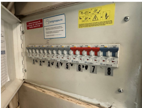
Sikringskap med automatsikringer.
