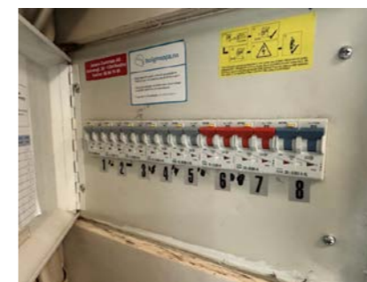
Sikringsskap med automatsikringer.
