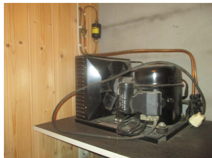
Aggregatet er plassert i bod.
