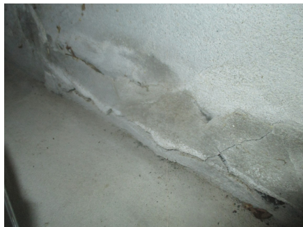
Fuktmerker og puss har løsnet.
