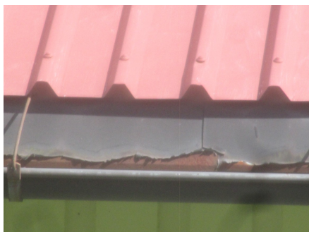
Belegg løsnet på skvettzink til takrenner.
