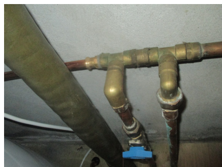
Deler av røropplegget
