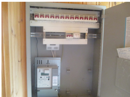
Sikringsskapet er plassert i vindfang.
