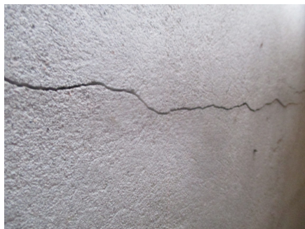
Sprekker vi garasje.
