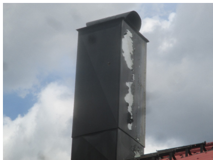
Helbeslått pipe. Belegg løsnet.
