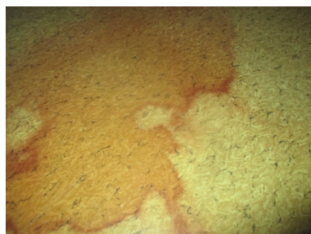
Større merker på gulvbelegget
