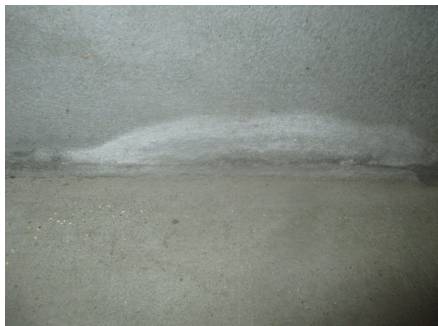
Noe saltutslag og fuktmerker i nedre del av grunnmur.
