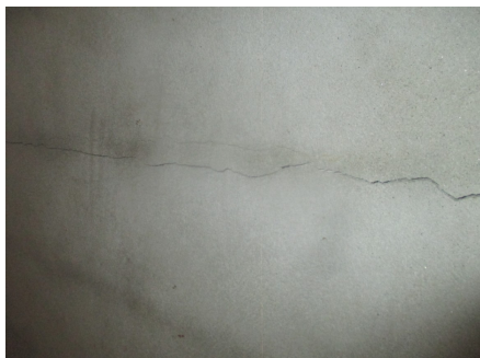
Sprekker i mellom murblokker lagerrom.
