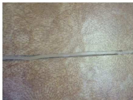
Sprekk i sveist skjøt.
