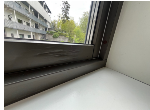
Skade på vindu soverom.
