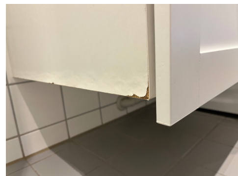
Svelling på innredning.
