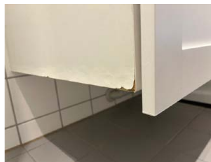
Svelling på innredning.
