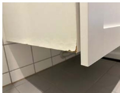
Svelling på innredning.
