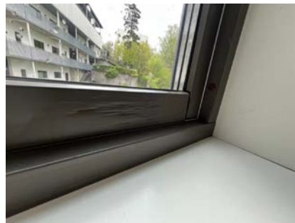
Skade på vindu soverom.
