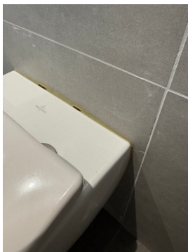
Sprukket flis og oppsprukket flisfuge ved siden av toalett
