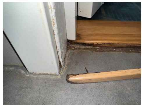
Fuktskadet dørtertsel/karm pga feil fall på gulv.
