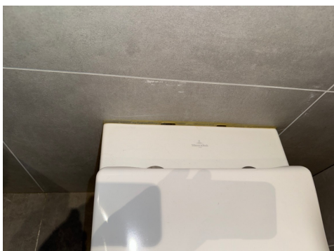
Dårlig feste på toalett
