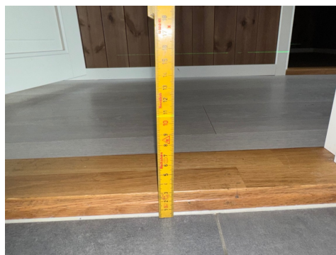
Topp gulv ved dørterskel (10,8cm)
