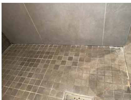
Oppsprukke og mangelfulle silikonfuger langs gulv i dusjhjørnet
