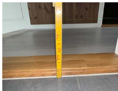
Topp gulv ved dørterskel (10,8cm)
