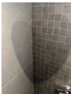
Oppsprukke silikonfuger i hjørner i dusjhjørnet
