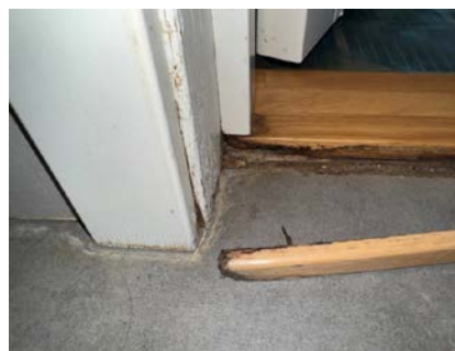
Fukskadet dørterksel/karm pga feil fall på gulv.
