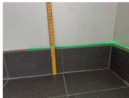
Målt gulv i utslagsvaskens våtsone (10,8cm)
