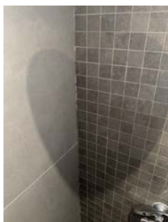
Oppsprukkede silikonfuger i hjørner i dusjhjørnet
