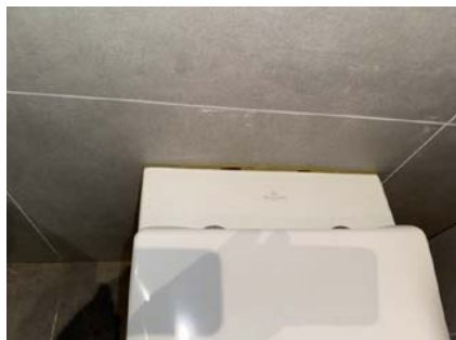
Dårlig feste på toalett
