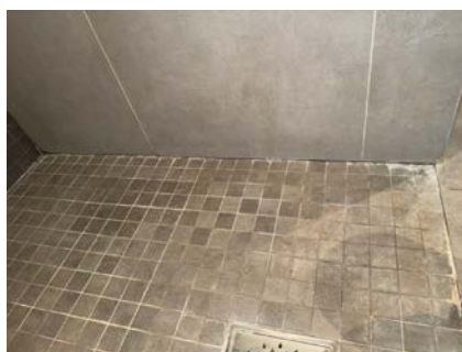
Oppsprukkede og mangelfulle silikonfuger langs gulv i dusjhjørnet
