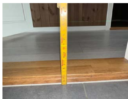
Topp gulv ved dørterskel (10,8cm)
