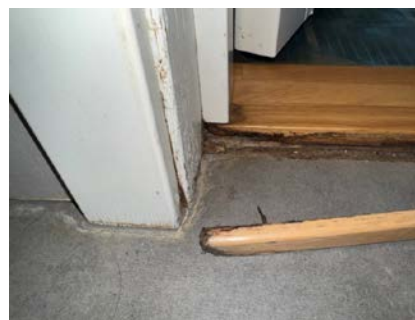
Fukskadet dørterksel/karm pga feil fall på gulv.
