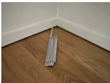
Glipper under gulvlister ved yttervegger, målt opptil ca.0,8 mm.
