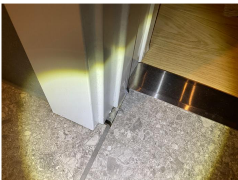
Område ved dørkarm som bør fuges
