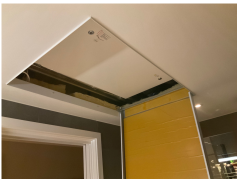
Motor plassert i himling på badrom
