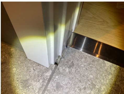
Område ved dørkarm som bør fuges
