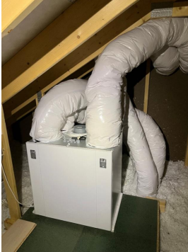
Ventilasjonsanlegg på møneloft.
