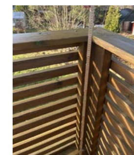
Rekkverk er lavere enn kravet.
