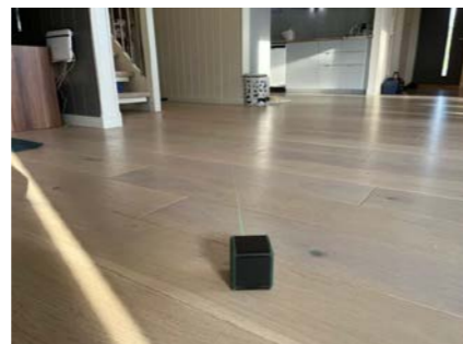
Det ble målt skjevheter på gulv.
