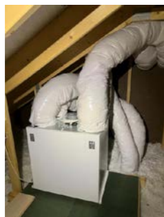
Ventilasjonsanlegg på møneloft.
