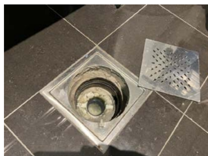
Sluk på vaskerom.
