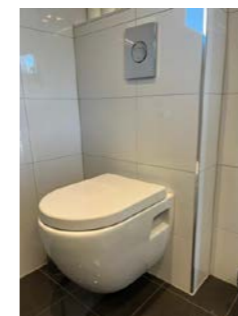
Nedtrekksfunksjon må utbedres.
