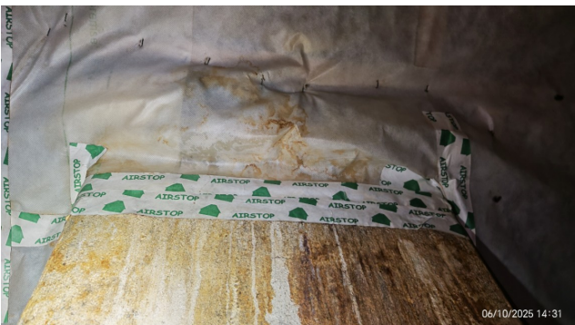
Fuktskjold ved pipe.
