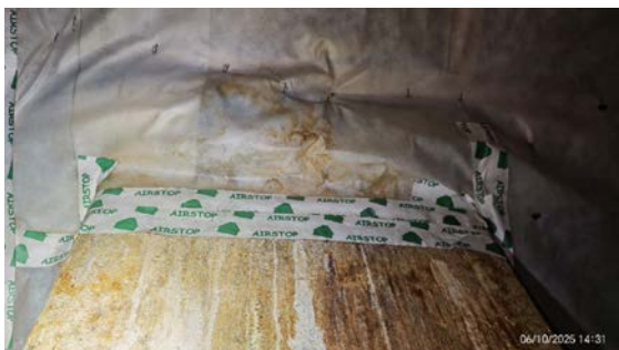
Fuktskjold ved pipe.
