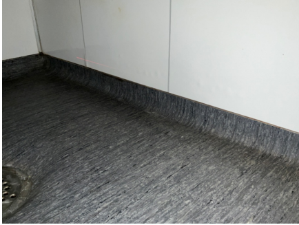
Fuktskader på overflatene.
