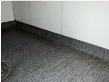
Fuktskader på overflatene.
