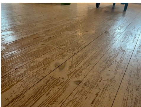
Slitasje på tregulv.
