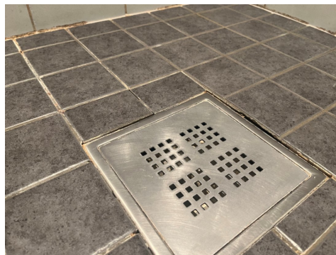
Løse fliser ved sluk i dusj.
