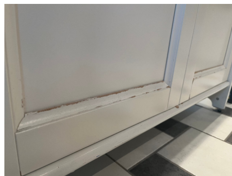
Servantskap med fuktskader.
