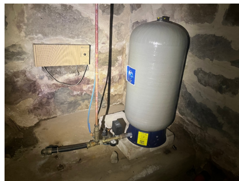
Akkumulatortank og stoppekran i krypkjeller.
