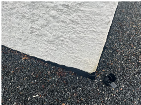
Synlig grunnmursplast uten klemlist.
