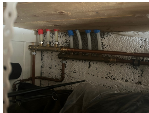
Vannrør av plast og kobber i kjeller.
