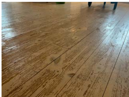
Slitasje på tregulv.
