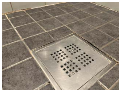
Løse fliser ved sluk i dusj.
