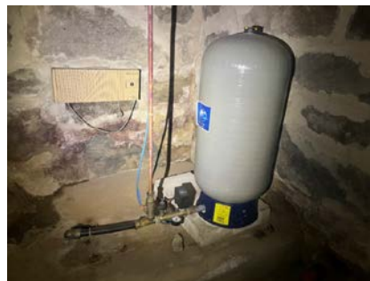
Akkumulatortank og stoppekran i krypkjeller.
