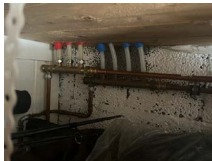
Vannrør av plast og kobber i kjeller.
