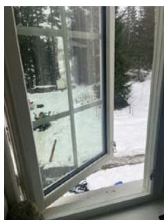
Manglende barnesikring av vinduer.
