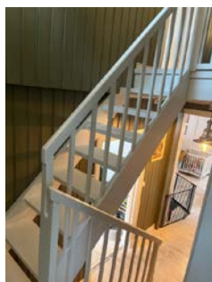
Trapp har sikkerhetsmangler i forhold til dagens krav.
