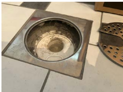
Sluk på gulv ved opplegg for badekar.
