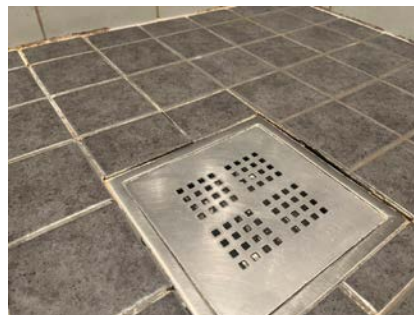
Løse fliser ved sluk i dusj.
