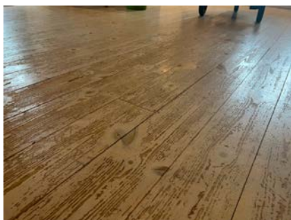
Slitasje på tregulv.
