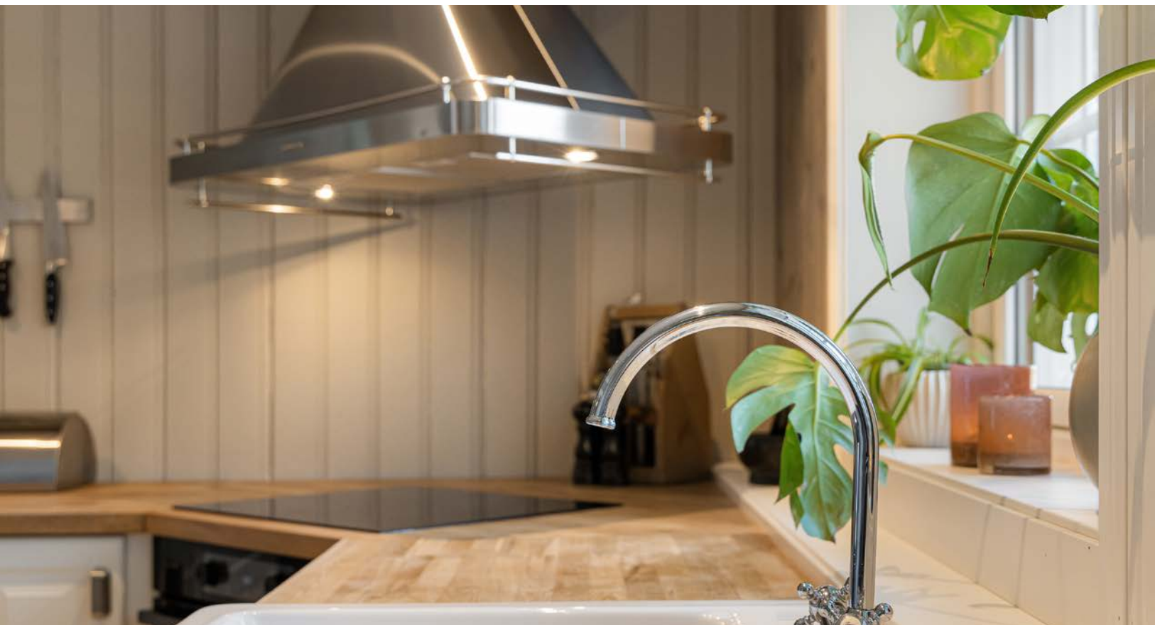
Over kokesonen er det ventilator etablert med avtrekk ut.
