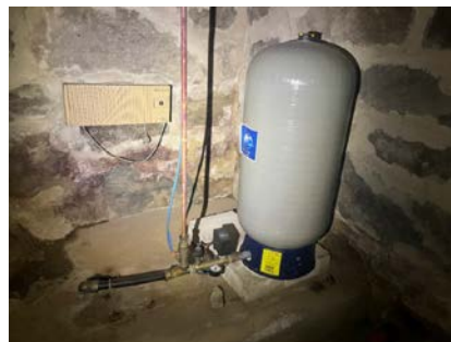
Akkumulatortank og stoppekran i krypkjeller.
