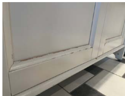
Servantskap med fuktskader.
