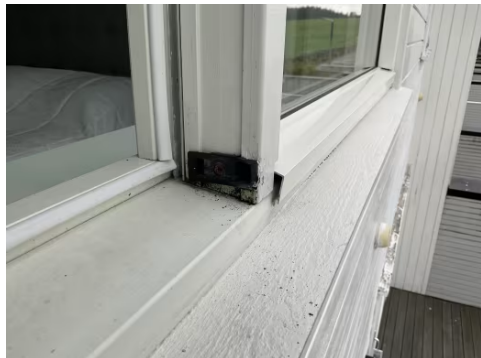
Det registreres begynnende nedbryting/råte nede på midtstokk i vindu på soverom
