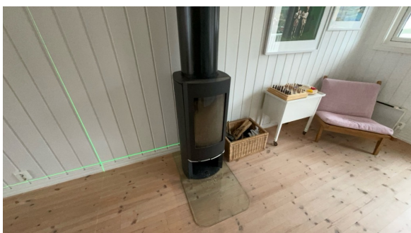
Montert ovn i stue.
