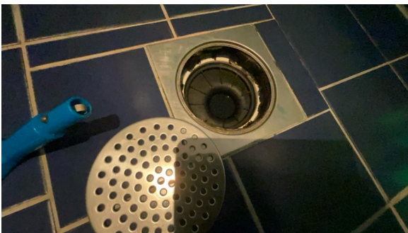
Sluk i gulv.
