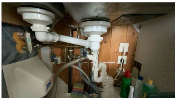
Del av rør til avløp.
