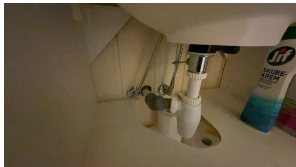
Del av rør til vann.
