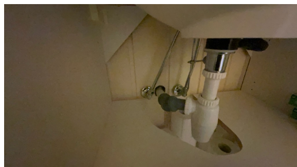
Del av rør til avløp.
