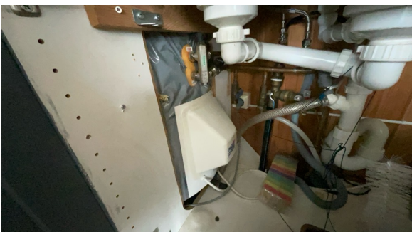
Varmtvannstank i kjøkkenbenk.
