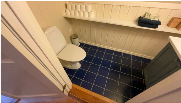
Del av toalettrom.
