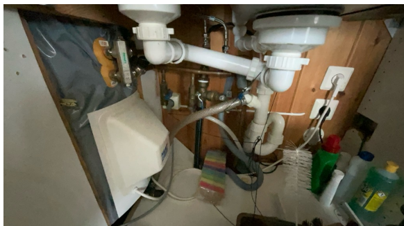
Stoppekran til vann. Del av rør til vann.
