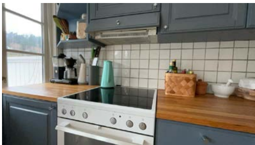
Montert avtrekk over komfyr.
