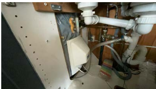
Varmtvannstank i kjøkkenbenk.
