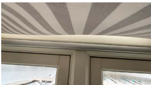
Eksempel på montert ventil i vindu.
