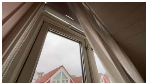
Eksempel på montert ventil i vindu.
