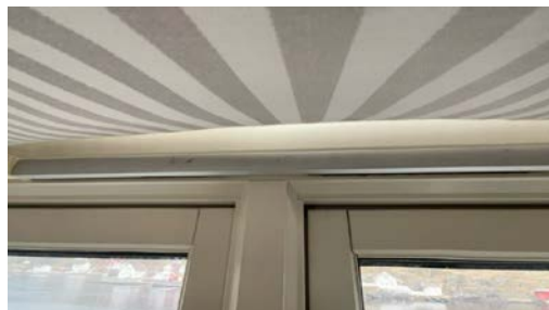
Eksempel på montert ventil i vindu.
