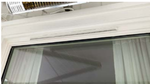
Eksempel på montert ventil i vindu.
