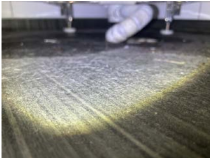
Sluk under dusjkabinett.
