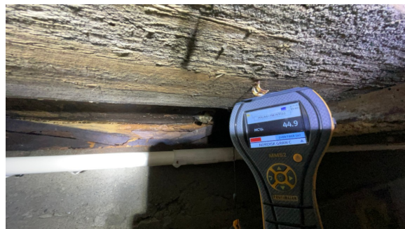
Fuktmåling - Krypromssiden - Høyt trefukttinnhold i skillekonstruksjonen.
