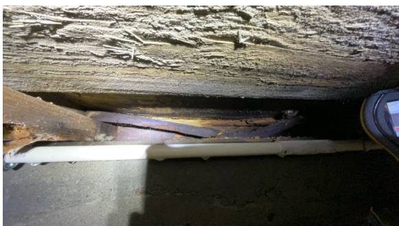
Råteskade - Konstruksjon over grunnmur.
