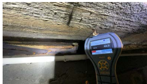
Fuktmåling - Skadelig høyt trefuktinnhold / vektprosent i skillekonstruksjonen.
