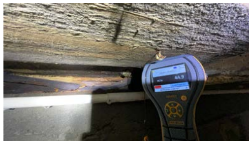
Fuktmåling - Krypromssiden - Høyt trefukttinnhold i skillekonstruksjonen.
