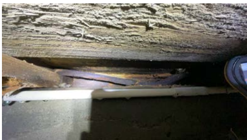
Råteskade - Konstruksjon over grunnmur.
