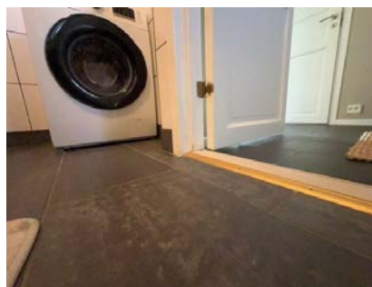
Terskel/membran er under 25 mm
