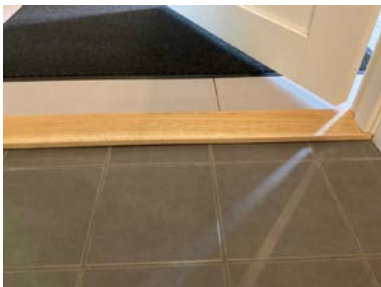
Manglende oppkant ved dørterskel.
