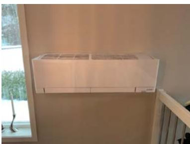
Luft til luft varmepumpe.
