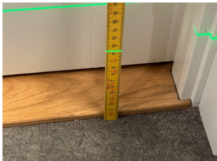
Fallforhold ca. 113 mm overkant gulv ved terskel
