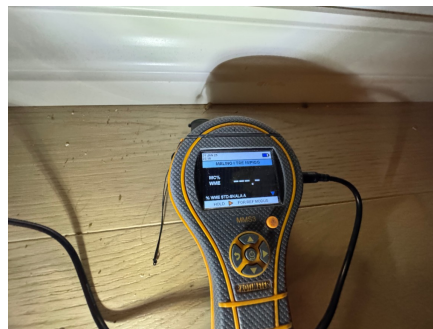
Fuktsøk med pigger i treverk
