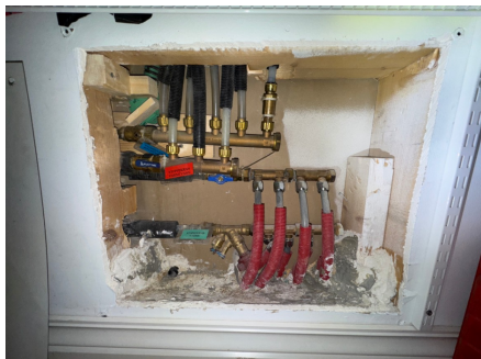
Inspeksjonsluke til rør-i-rør
