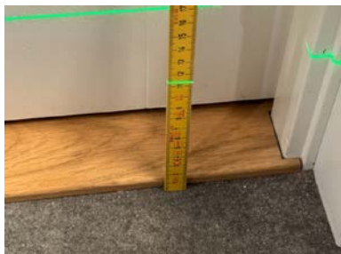
Fallforhold ca. 113 mm overkant gulv ved terskel
