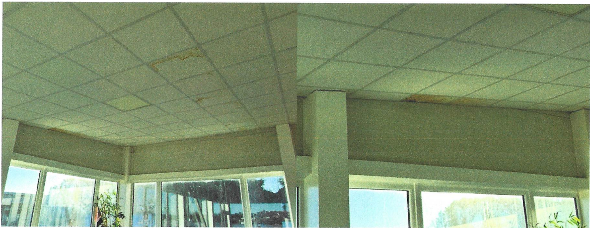
Eksempel på takplater hvor det er fuktmerker.
