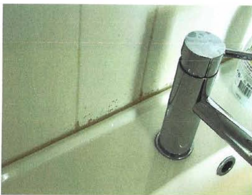
Fuktskade i veggplate ved vask på badet.
