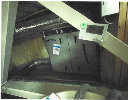
Ventilasjonsanlegget med tablå festet med magnet på ståldrager.
