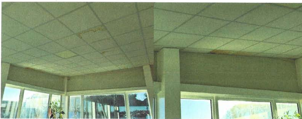
Eksempel på takplater hvor det er fuktmerker.
