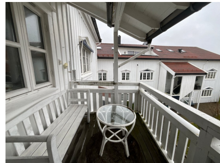
Sprekker i terrassebord.
