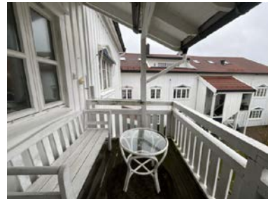
Sprekker i terrassebord.
