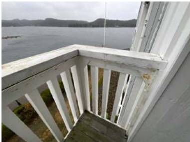
Rust på innfestinger.
