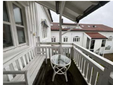
Sprekker i terrassebord.
