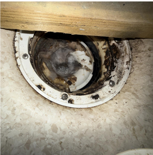
Sluk under dusjkabinett
