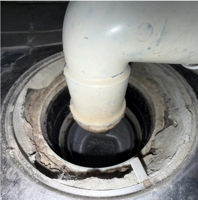
Sluk under dusjkabinett
