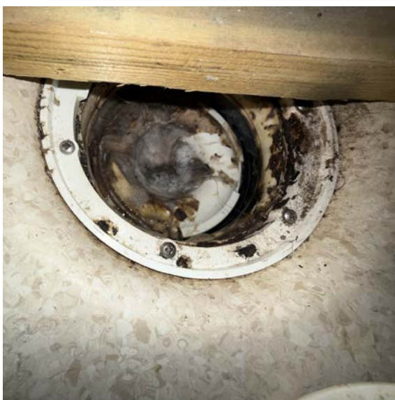
Sluk under dusjkabinett
