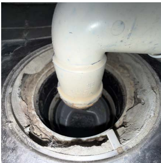
Sluk under dusjkabinett
