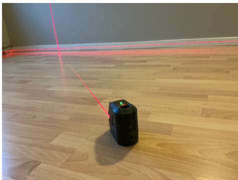
Nivellering soverom, avvik ca. 10-20 mm
