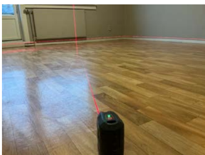
Nivellering stue, avvik ca. 15-30 mm
