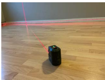
Nivellering soverom, avvik ca. 10-20 mm
